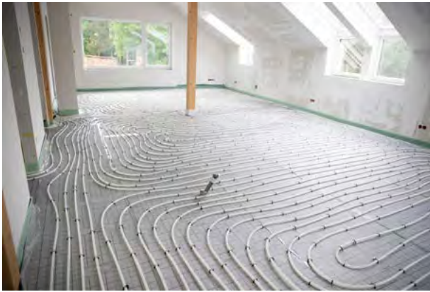
Instalación doméstica con suelo radiante
