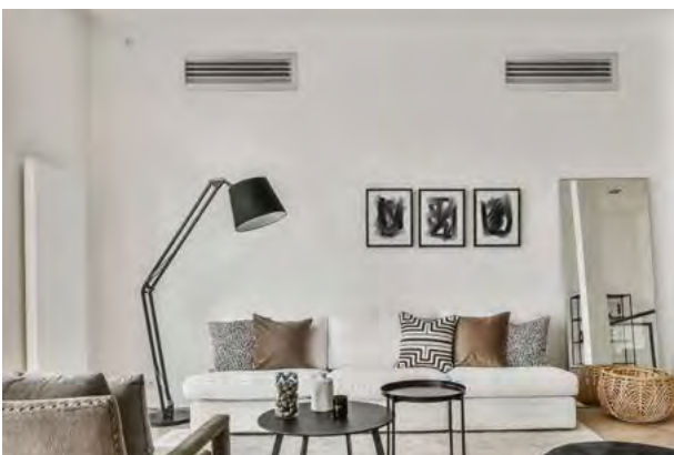
Instalación doméstica por fancoils
